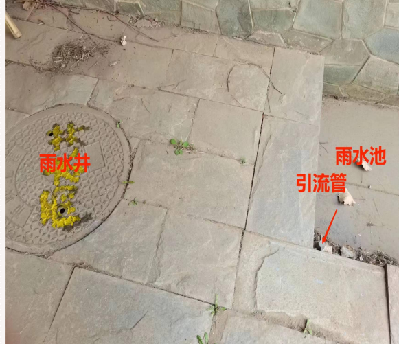
厂区雨收集装置图片-2
