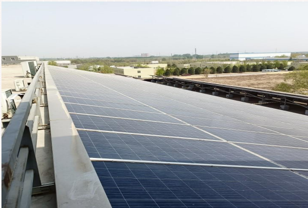
400KW 光伏屋顶发电项目-1
