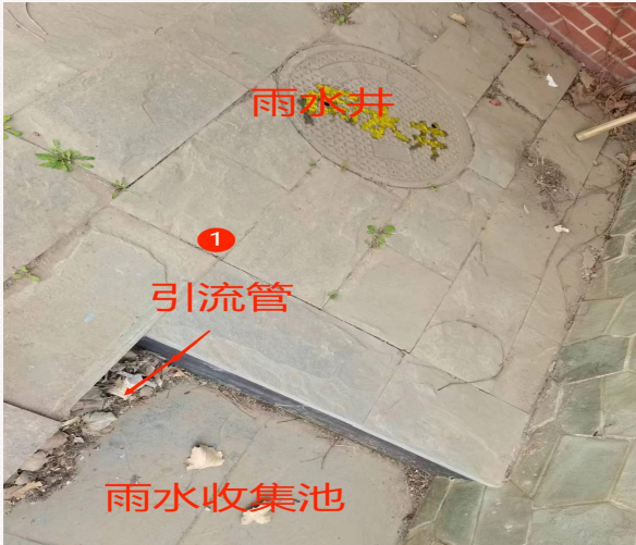
厂区雨收集装置图片-1
