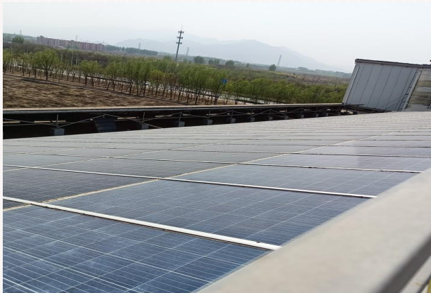
400KW 光伏屋顶发电项目-2
